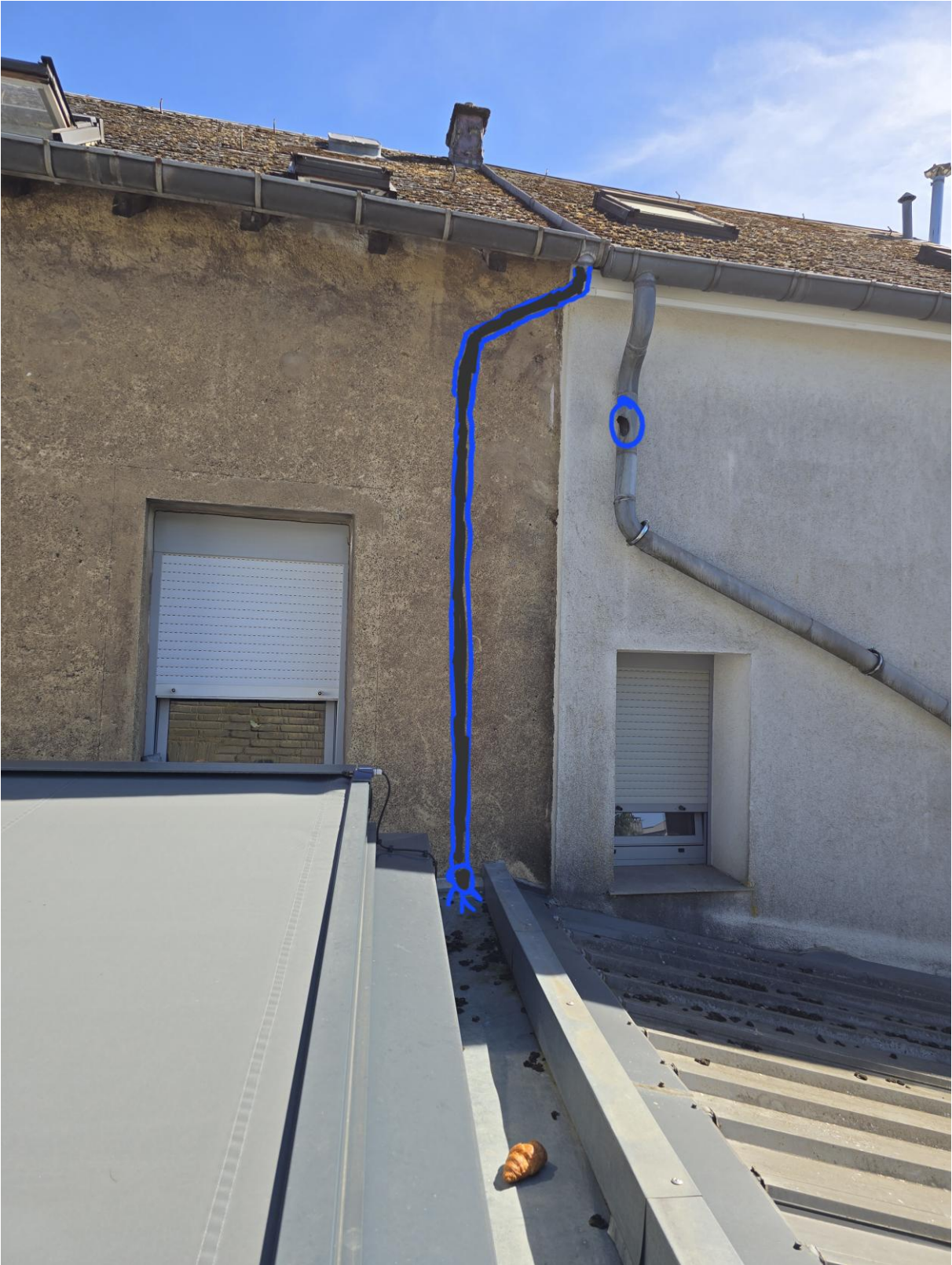
Descente de gouttière de toit et bouchage trou sur le coté du tuyau
